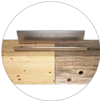
4.受损部件的修复
