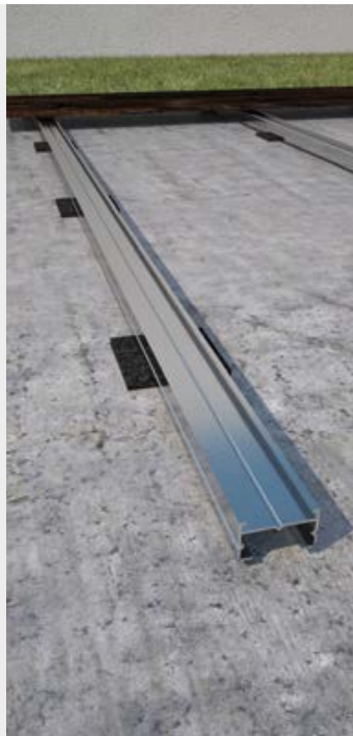
Substructură din aluminiu realizată cu ALUTERRA30 și poziționată pe GRANULO PAD
