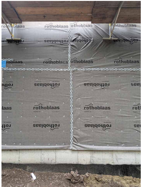
Giunti verticali allineati creano una linea preferenziale per infiltrazioni. Mancata nastratura alle estremità e in corrispondenza dei fissaggi.
