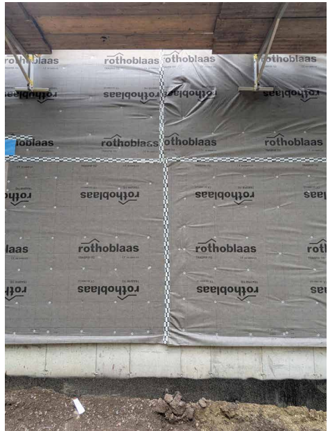
Les jonctions verticales alignées créent une ligne privilégiée pour les infiltrations. Absence de rubans adhésifs aux extrémités et au niveau des fixations.
