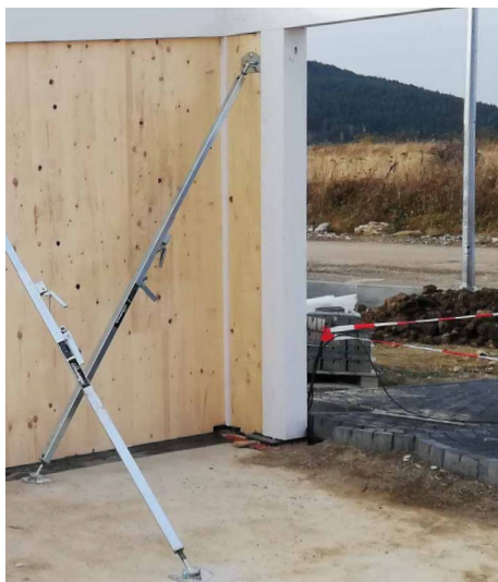
Mur en bois situé sous le niveau fini extérieur, sans isolation sous le mur en bois (risque de pont thermique) et système d'imperméabilisation inadéquat.
