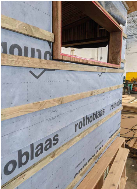
Membrane non scellée par du ruban adhésif et absence de scellement au niveau des clous.
