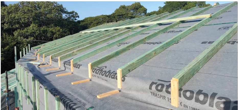
Absence de scellement au niveau des clous, notamment dans les zones à faible pente.
