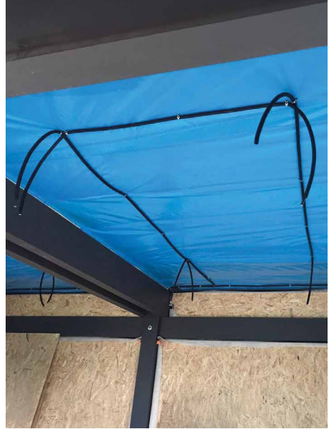
Barrera de vapor dañada en varios puntos por las instalaciones y por fijaciones no encintadas, sin restablecimiento de la continuidad de la capa
