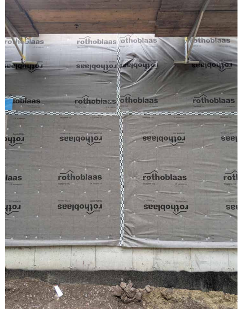
Uniones verticales alineadas crean una línea que facilita las filtraciones. Falta de encintado en los extremos y en las fijaciones.
