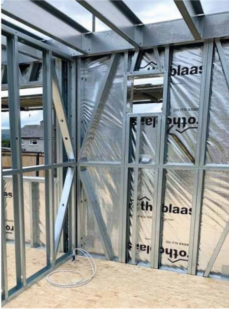
Barrera de vapor instalada sin encintado de las uniones y con posible reducción de las prestaciones de estanquidad al aire y control del vapor.
