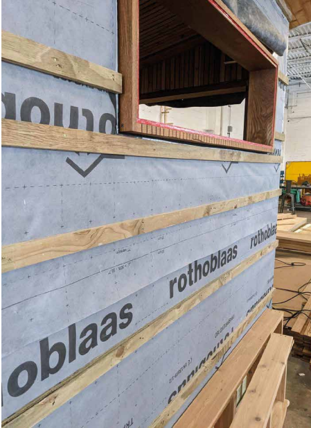
Lámina no encintada y falta de sellado del clavo.
