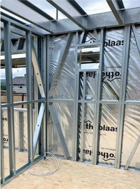
Dampfsperre, verlegt ohne Abklebung an den Stößen, mit möglicher Beeinträchtigung der Luftdichtheit und Feuchteregulierung.
