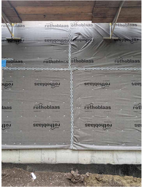
Übereinanderliegende vertikale Stöße bilden einen bevorzugten Pfad für Wassereintritt. Fehlende Abklebung an den Enden und im Bereich der Befestigungen.
