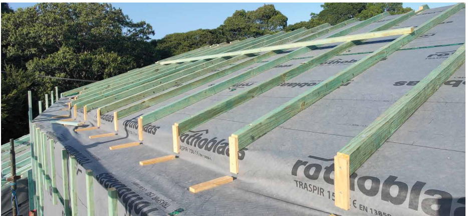
Fehlende Nageldichtung, insbesondere in Bereichen mit geringem Gefälle.
