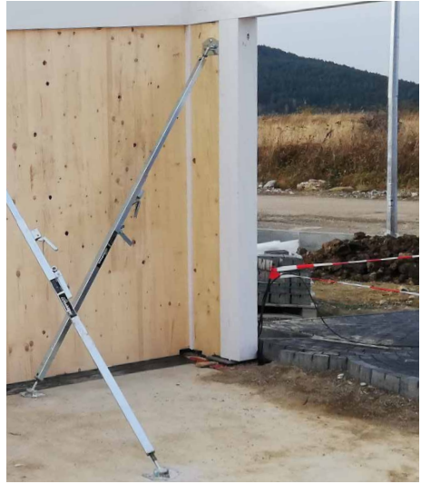
Holzwand unterhalb des fertigen Außenfußbodens, Fehlen einer Dämmung unterhalb der Holzwand (Risiko einer Wärmebrücke) und ungeeignetes Bauabdichtungssystem.
